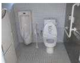
浄化槽での使用
